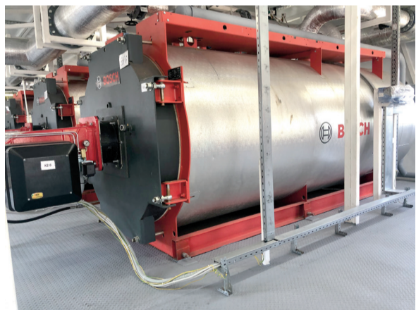
Новые котлы успешно прошли пусконаладку.
