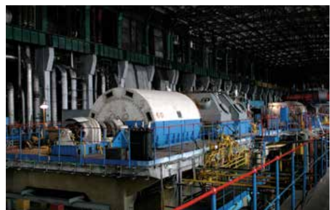
Капитальный ремонт турбогенератора ТВФ-100 ст. № 6 позволит обеспечить его надежную работу с выдчей номинальной мощности на ближайшие 6 лет
