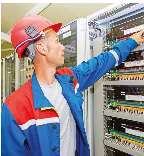
■ Электрический цех Приморской ГРЭС
