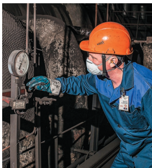
Ⓢ Контроль давления в барабане котла
