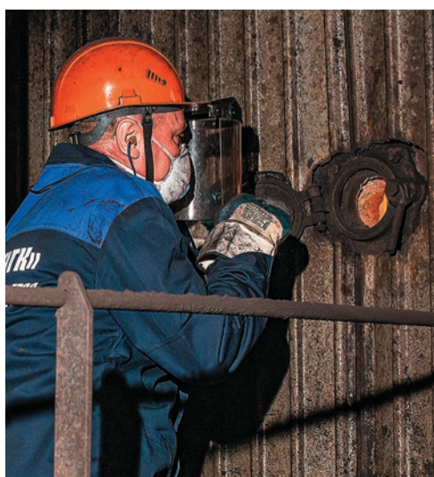
Ⓢ Визуальный контроль факела в топке
