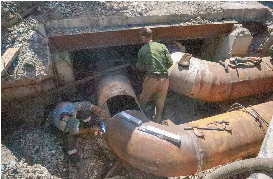
© Все выявленные повреждения теплотрассы оперативно устраняются. Фото: Екатерина Сенько
