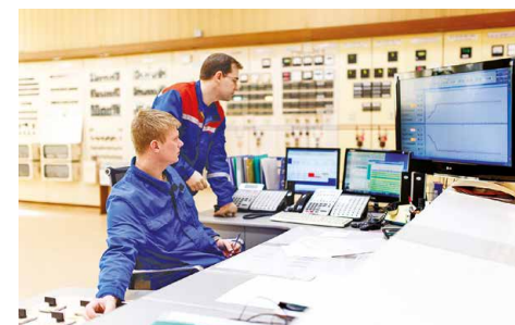
Главный щит управления Владивостокской ТЭЦ-2
