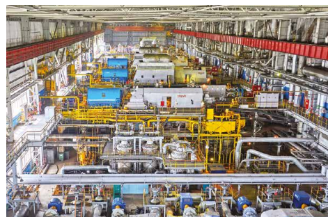
Турбинный цех БТЭЦ
