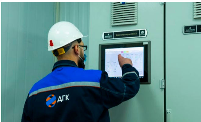
Автоматизированная система управления позволит дистанционно вести контроль за работой объекта
