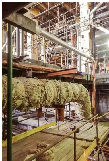
Ф. Новый главный паропровод установили на смену предшественнику, отслужившему верой и правдой 40 лет. Фото из архива Райчихинской ГРЭС
