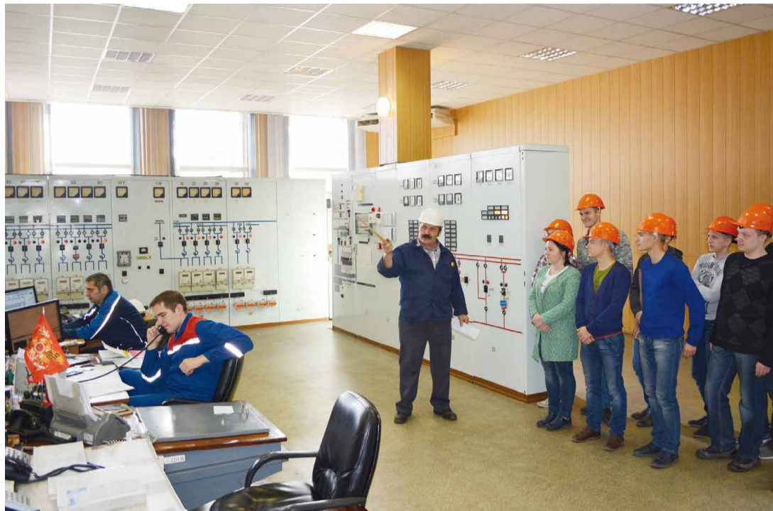
Студенты базовой кафедры на главном щите управления КТЭЦ-2 с ведущим инженером электроцеха Александром Хухриным
