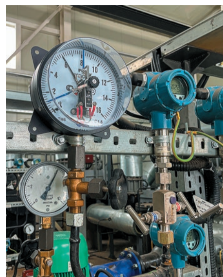
© Всего на ПНС установлено шесть насосов. Фото Семена Симоненко
