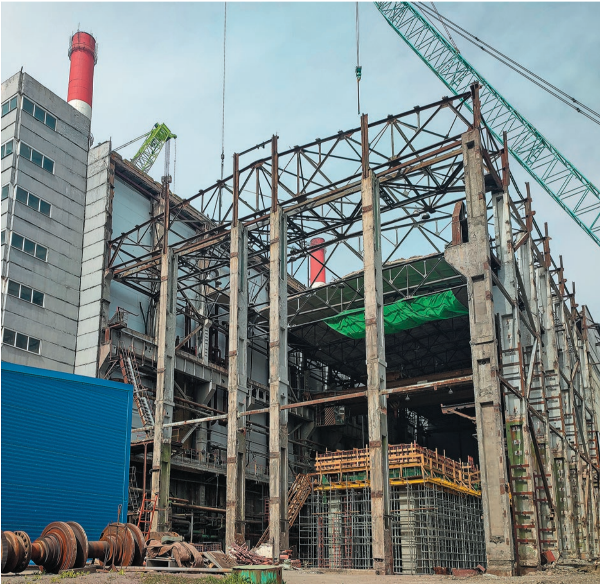
© В котельном отделении энергетики собрали каркас и завершили монтаж поверхностей нагрева в предпроектное положение, в турбинном отделении завершается устройство фундамента. Фото Александры Зуевой
