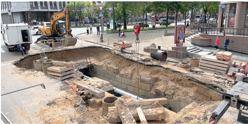
© Программа повышения надежности и снижения потерь на тепловых сетях позволит ДГК увеличить объемы ремонтов и модернизаций на теплотрассах. Фото: пресс-служба ДГК
