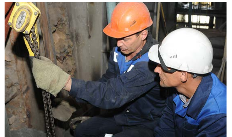
Оборудование Биробиджанской ТЭЦ и теплосети города готовят к следующему отопительному сезону. Фото Татьяны Евменовой
