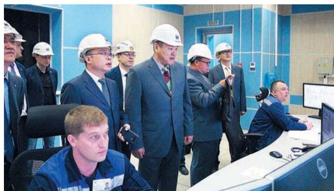
Щит управления второй очереди Благовещенской ТЭЦ
