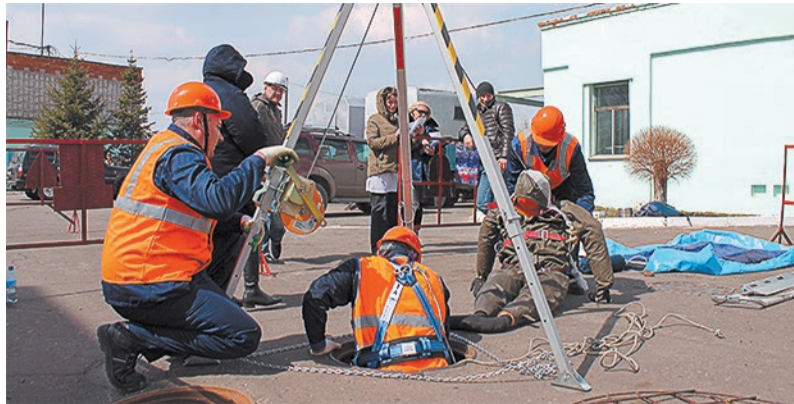
В РАМКАХ ПРАКТИЧЕСКОЙ ЧАСТИ конкурсанты должны были устранить условное повреждение оборудования теплосети.
