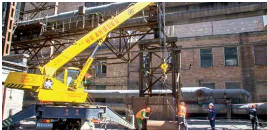
На Артемовской ТЭЦ энергетики устраняют причину аварии на сетевом трубопроводе
