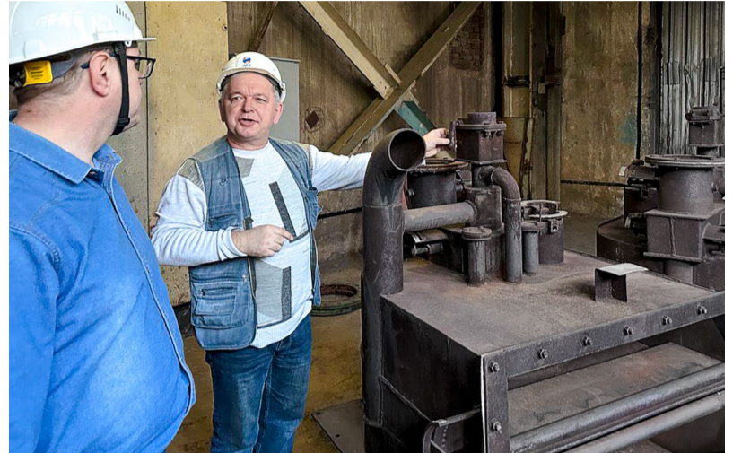
© Сергей Кирсанов показывает Алексею Шестакову газовую горелку, которая ждет установки на котел. Фото: Ольга Божедомова
