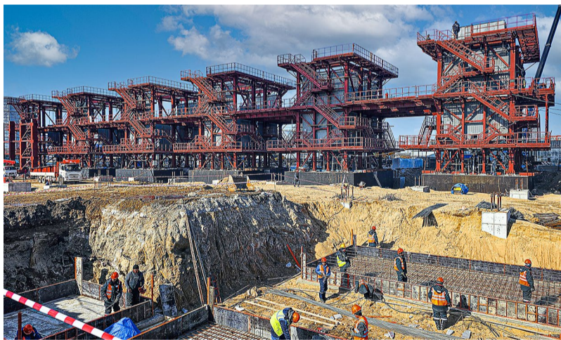
© Комплекс теплофикационной установки (водогрейная котельная) вступит в строй еще до пуска станции. Фото: пресс-служба ДГК
