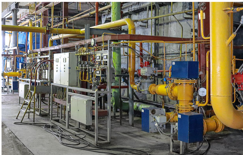
© На объединенной котельной «Северная» прошли плановый ремонт уже четыре котла. Фото: Екатерина Сенько
