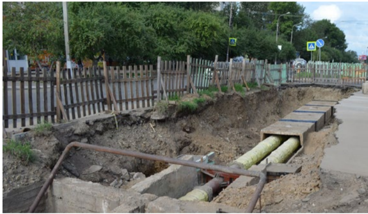
© В городе Юности ремонтные работы идут на четырех теплотрассах. Фото пресс-службы администрации Комсомольска
