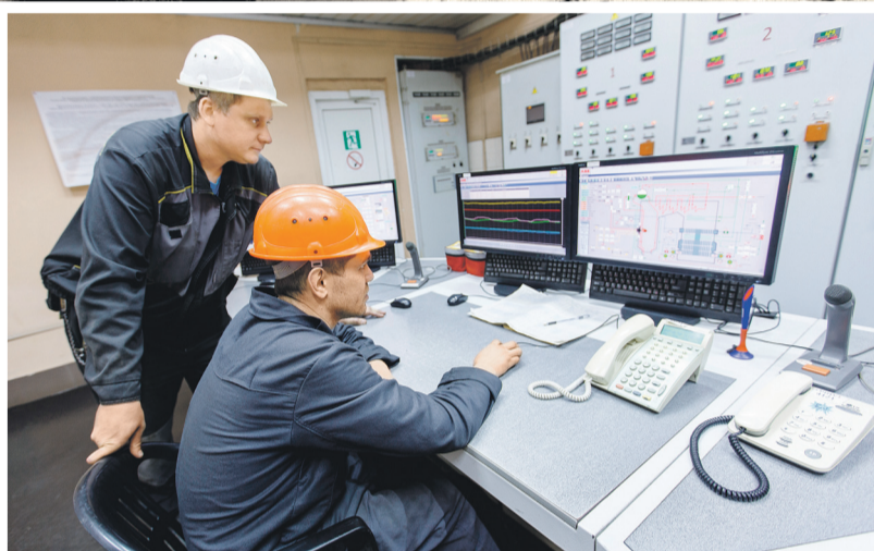
Щит управления котлоагрегатами после газификации
