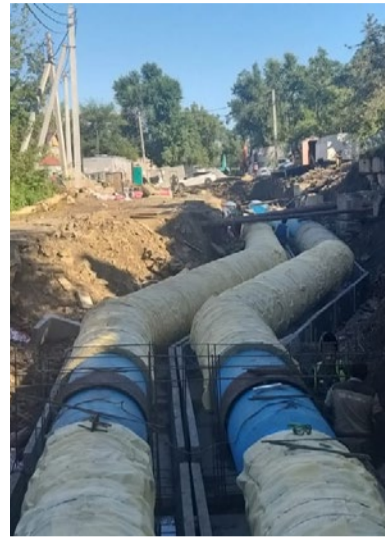
© Плановая перекладка участка магистральной теплотрассы в районе улицы Героев Хасана. Фото Любови Будяковой
