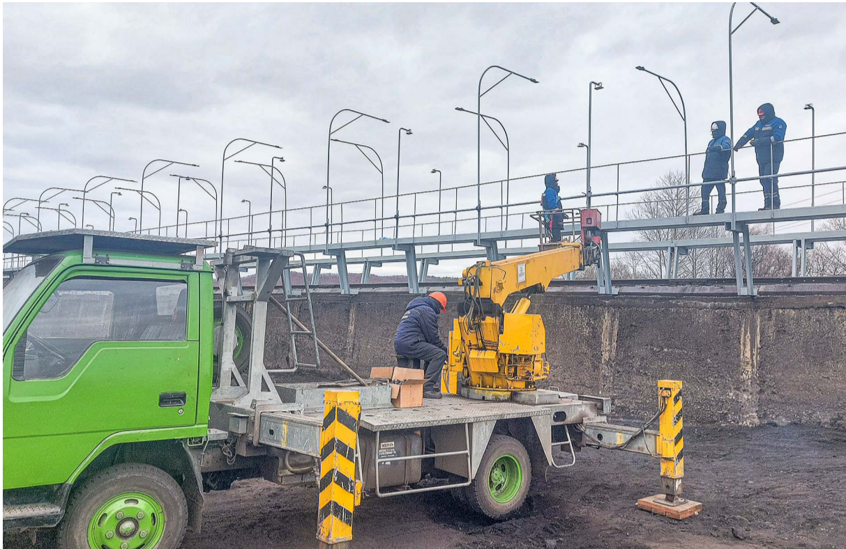
© Новый погрузчик поможет в обеспечении бесперебойной работы топливоподачи. Фото: Ольга Гордиенко
