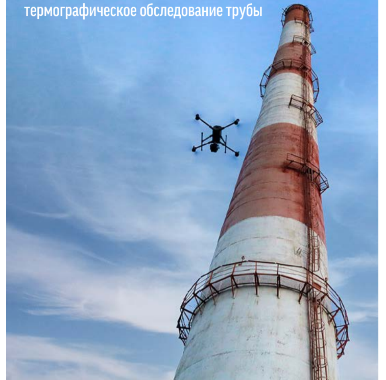
© Термографическое обследование позволяет оценить износ дымовой трубы и выявить дефекты на ранней стадии. Фото: Екатерина Сенько
