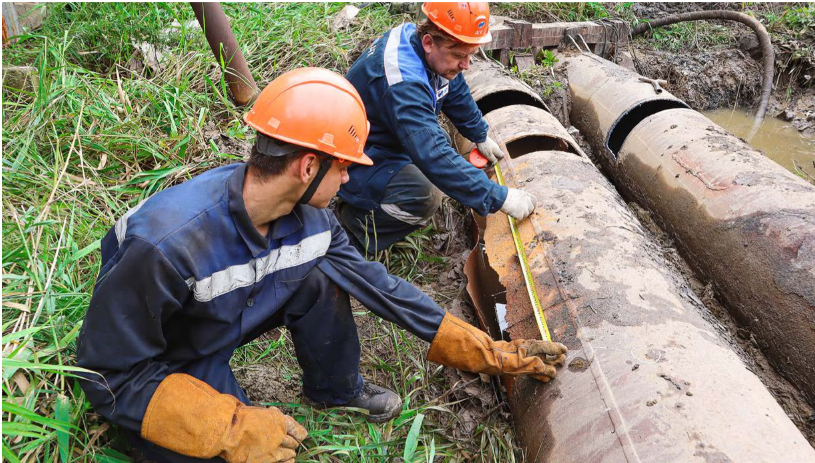
© Замена аварийного участка трубы, не выдержавшего нагрузки во время гидравлических испытаний. Фото: Екатерина Сенько
