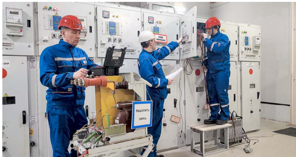
На ТЭЦ «Восточная» специалисты готовятся к новому отопительному сезону. Фото: Александра Зуева
