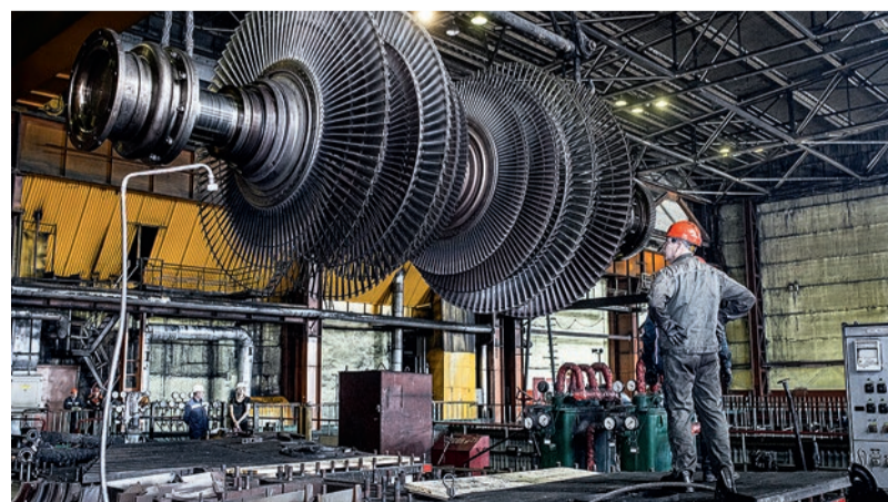
© В ходе предстоящих ремонтных работ на Нерюнградской ГРЭС обновят котельное, турбинное и электротехническое оборудование. Фото Романа Зарышнюка
