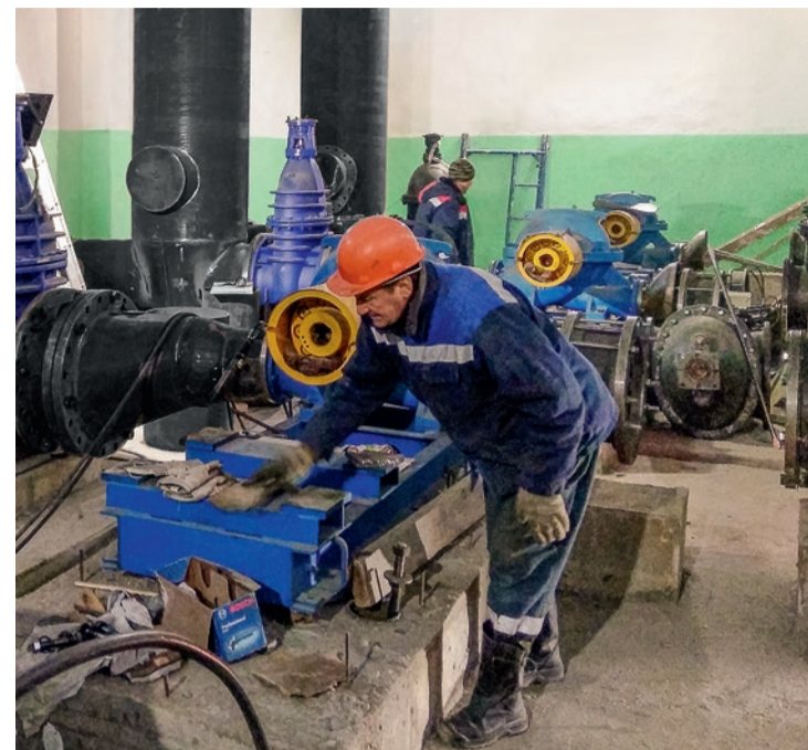
© Станция «осветленки» поможет внедрить на Амурской ТЭЦ-1 обратное водоснабжение. Фото из архива пресс-службы Хабаровской генерации
