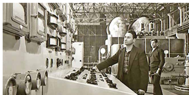
■ Щит управления Хабаровской ТЭЦ-1, 1967 год
