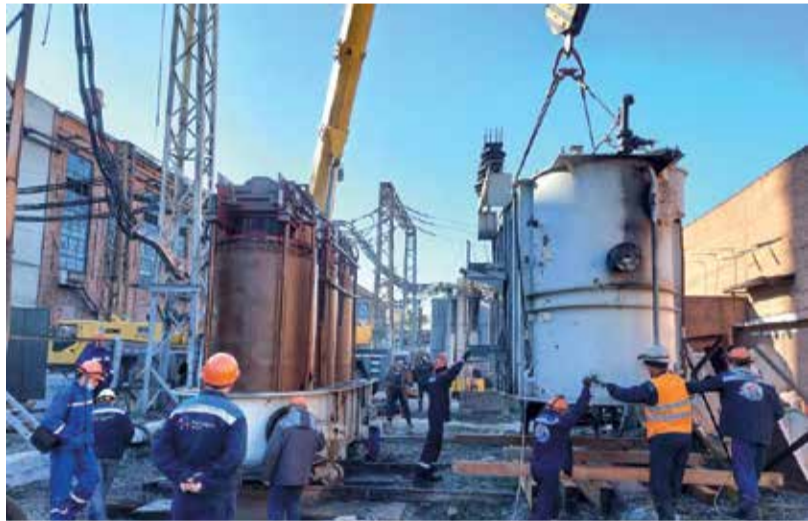
Бак трансформатора уже открыт
