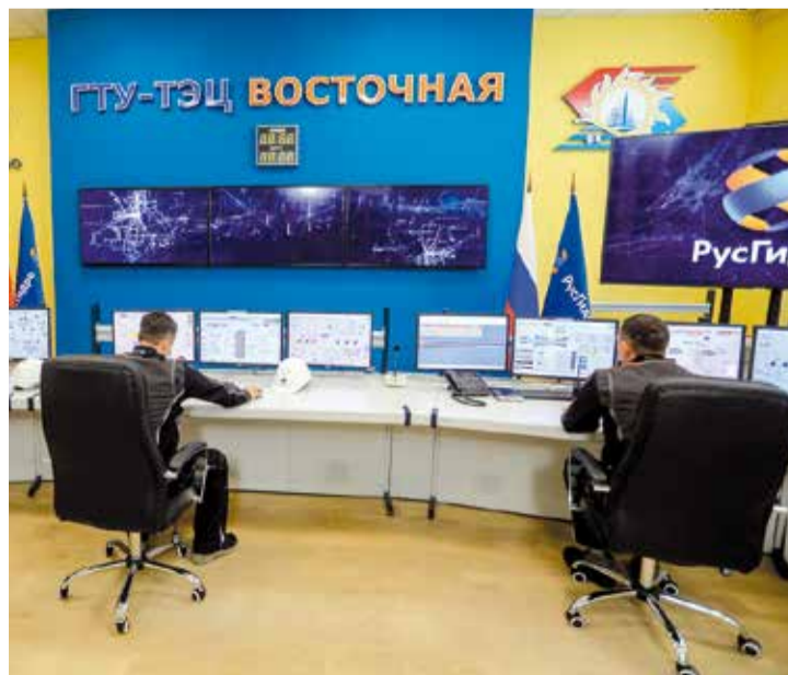
Блочный щит управления ТЭЦ «Восточная»
