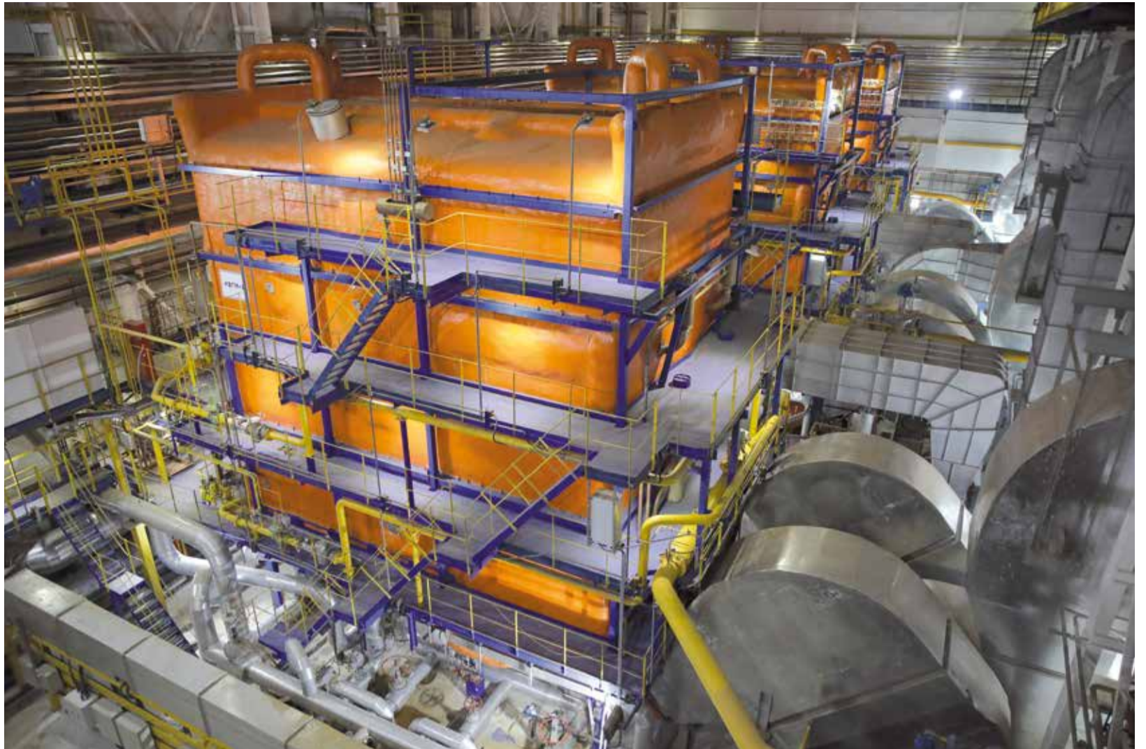
Помещение пиковой водогрейной котельной
