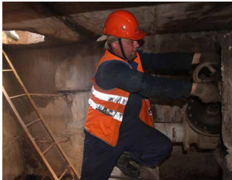
Слесарь Николай Мальцев проверяет задвижки в подземной тепловой камере
