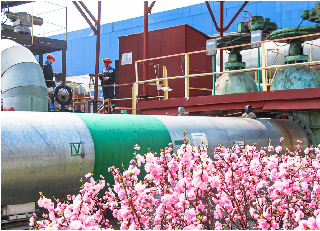
© Ремонтные бригады АТС уже приступили к устранению дефектов, выявленных на теплосетях. Фото: Александра Зуева
