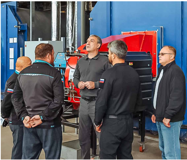
© Первая газовая котельная Благовещенска оснащена шестью современными котлами мощностью 94,5 МВт. Фото: amurobl.ru
