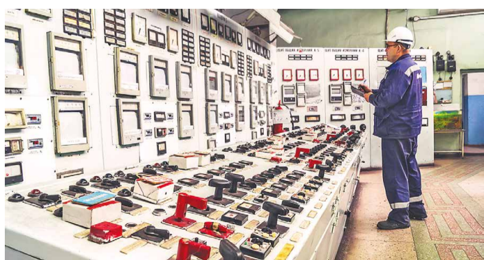
Главный щит Биробиджанской ТЭЦ
