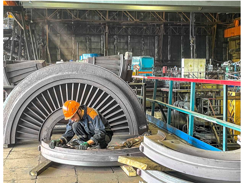
© На Нерюнградской ГРЭС выполняются не только плановые ремонты, но и мероприятия программы повышения надежности. Фото: Анна Неустрова
