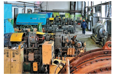
© Газотурбинные установки Майской ГРЭС прослужили людям почти 45 лет и ушли на заслуженный отдых
