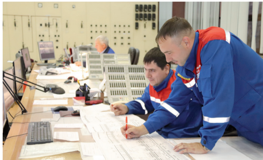
На главном щите управления Приморской ГРЭС
