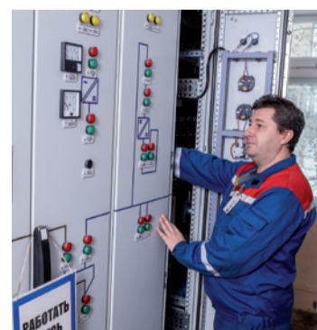
Техническое обслуживание щита постоянного тока
