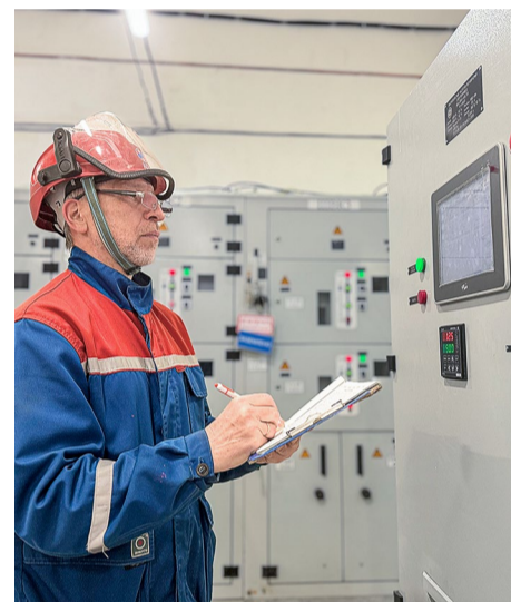
© Осмотр оборудования частотно-регулируемого привода. Фото: Александра Зуева
