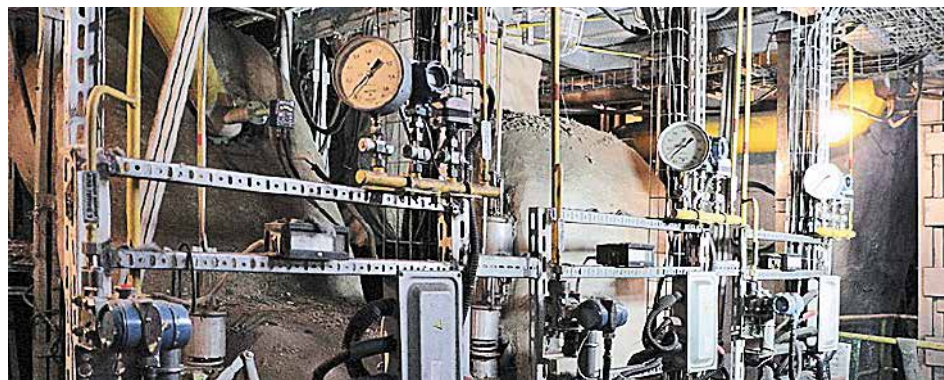
В РАМКАХ РЕКОНСТРУКЦИИ КОТЛОАГРЕГАТ № 14 БЫЛ ОСНАЩЕН ОБОРУДОВАНИЕМ ДЛЯ ПОДАЧИ ГАЗА. СМОНТИРОВАНЫ ШЕСТЬ ГОРЕЛОЧНЫХ УСТРОЙСТВ, КОТОРЫЕ ПОДАЮТ ГАЗ В ТОПКУ КОТЛА: ТРИ — С ЛЕВОЙ СТОРОНЫ И ТРИ — С ПРАВОЙ
