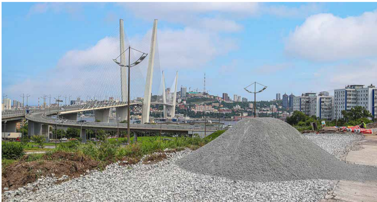
Ⓢ Работы возле Приморской сцены Мариинского театра велись оперативно, чтобы успеть к началу театрального сезона. Фото: Екатерина Сенько
