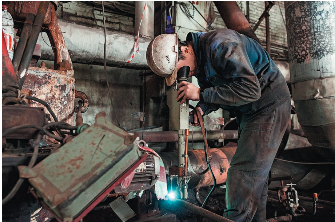
© На ремонт оборудования всех энергообъектов в 2021 году в ДГК было заложено 2,09 млрд руб. Фото из архива ДГК
