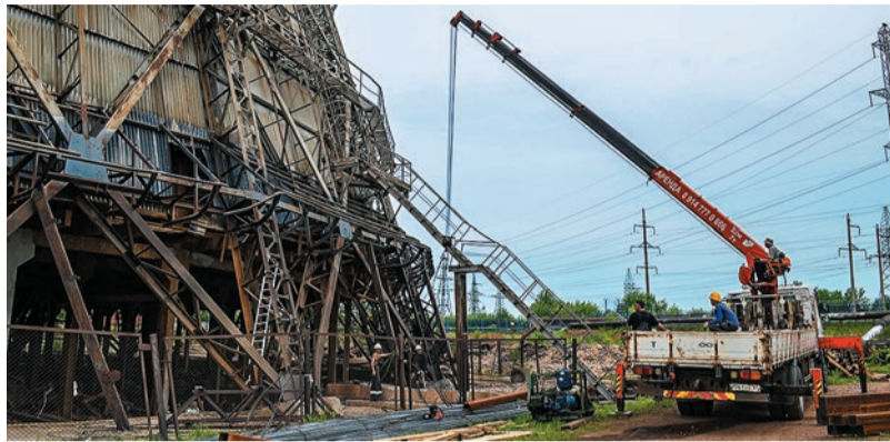
© Сигнальную окраску градирни тоже обновят. Фото Марины Булдыгеровой
