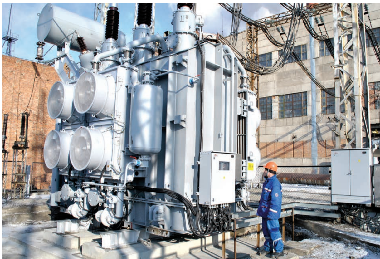
Начальник смены электроцеха Хабаровской ТЭЦ-1 Игорь Лученко проверяет показатели трансформатора во время обхода
