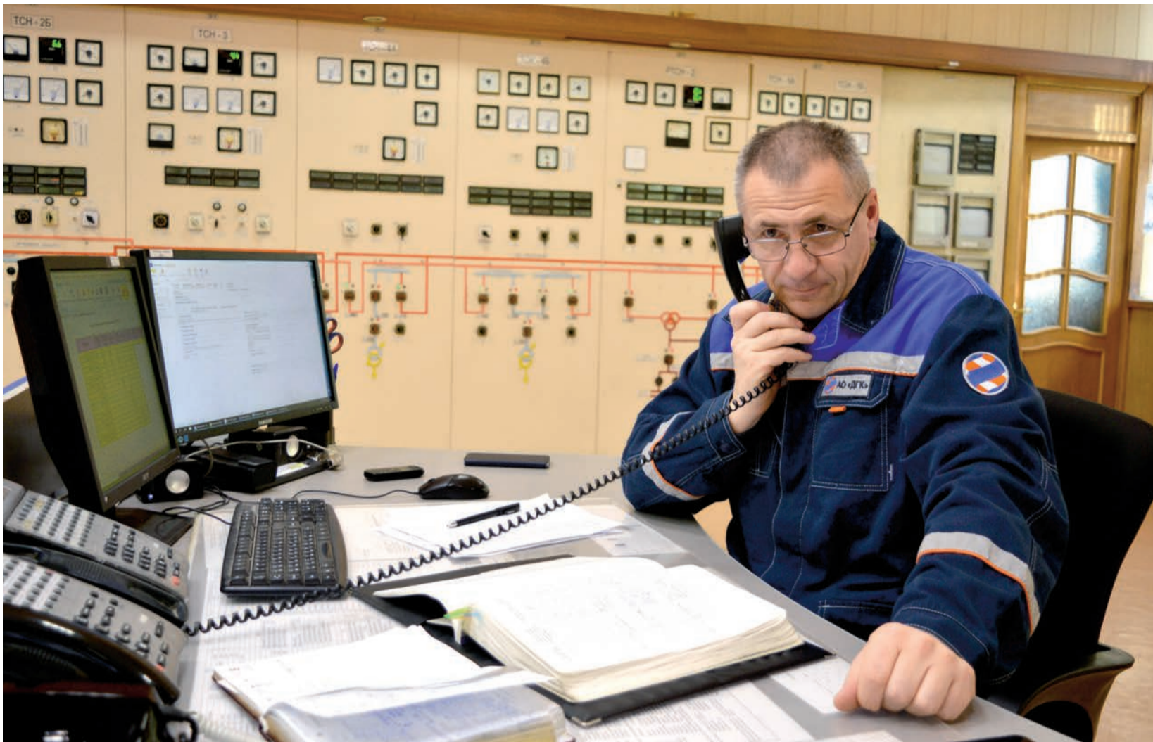
Рабочее место начальника смены станции находится на главном щите управления, где отображается вся информация о технологическом процессе работы энергоблоков
