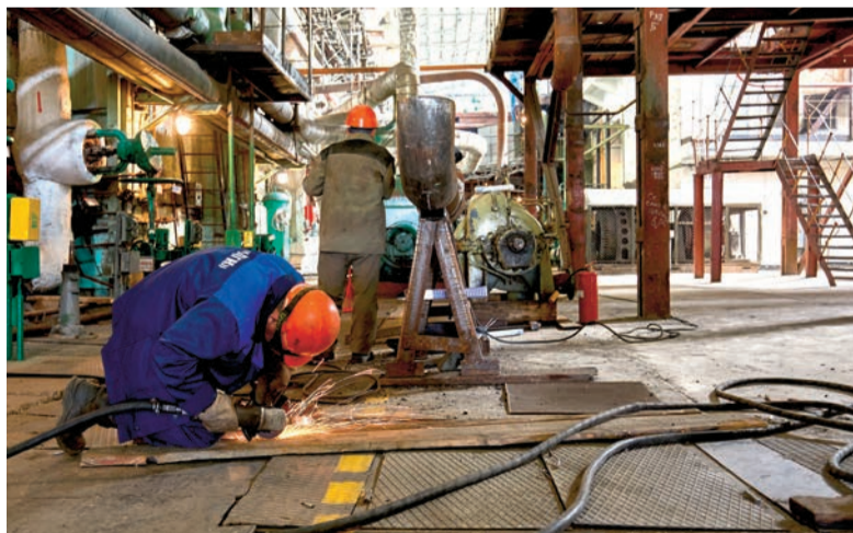
Работы на Райчихинской ГРЭС
