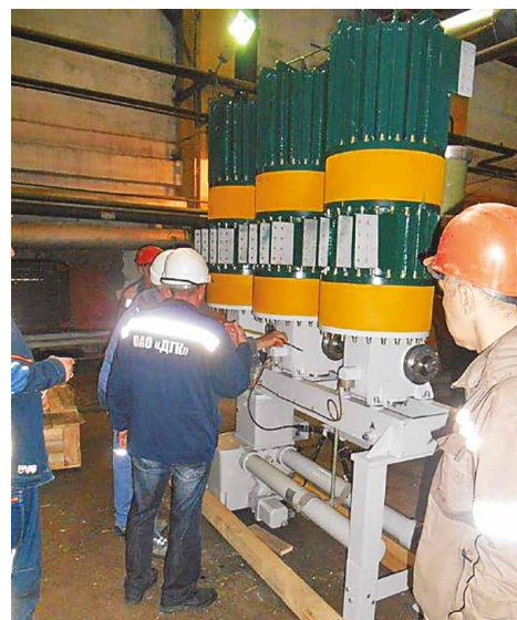
■ Новое оборудование доставили на ГРЭС
